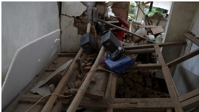
Gambar 17. Dampak Kerusakan Gempabumi M 4.8 di Sumedang
